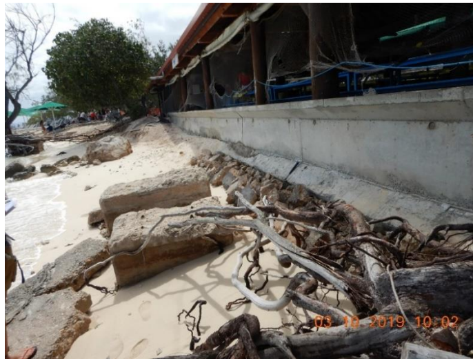
Photo n° 5 : Îlot Amédée – Bâtiment au bord du trait de côte
