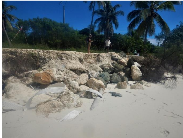
Photo n° 8 : Exemple d'ouvrage dégradé à Ouvéa (proche cimetière de Mouli)
