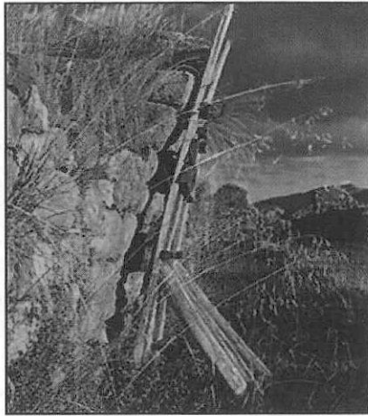
Detalle del apuntalamiento con pronunciada inclinación debido al peso de los muros líticos.
