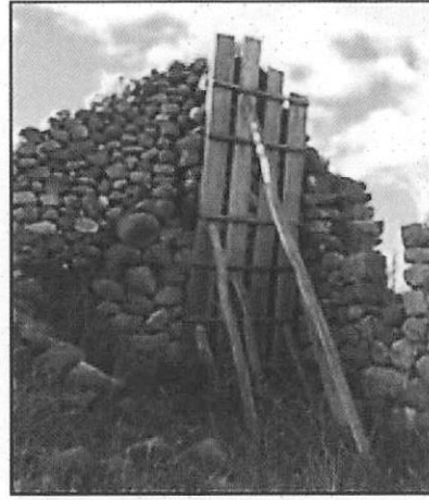
Apuntalamiento de madera desgastados por el paso del tiempo.
