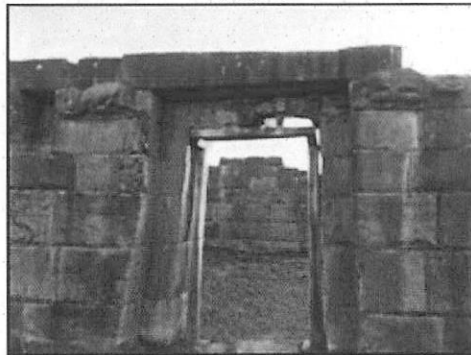
Apuntalamiento de madera sosteniendo el dintel de piedra, con alto riesgo de colapso.
