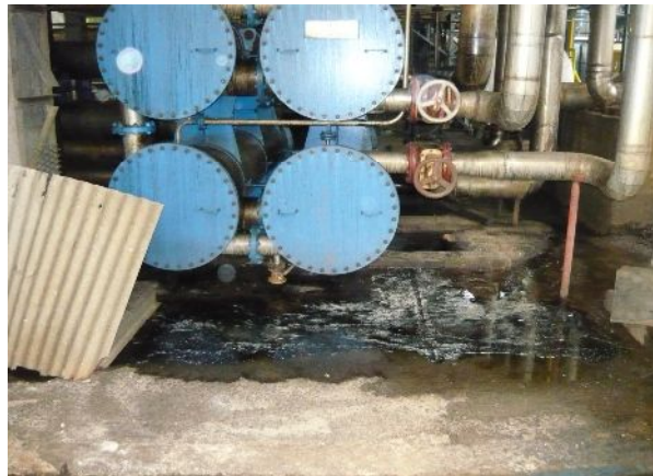
Pérdidas de agua y derrames de líquidos, en la Planta Petropar de Mauricio J. Troche.
