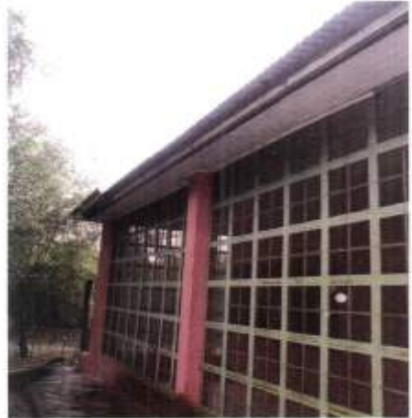
Techo sin canaletas en el Parque Nacional Defensores del Chaco Fuente: CGR
