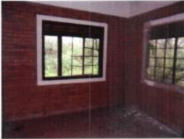
Puesto de Guardaparques Siracua, abandonado, en el Parque Nacional Teniente Agripino Enciso. Fuente: CGR
