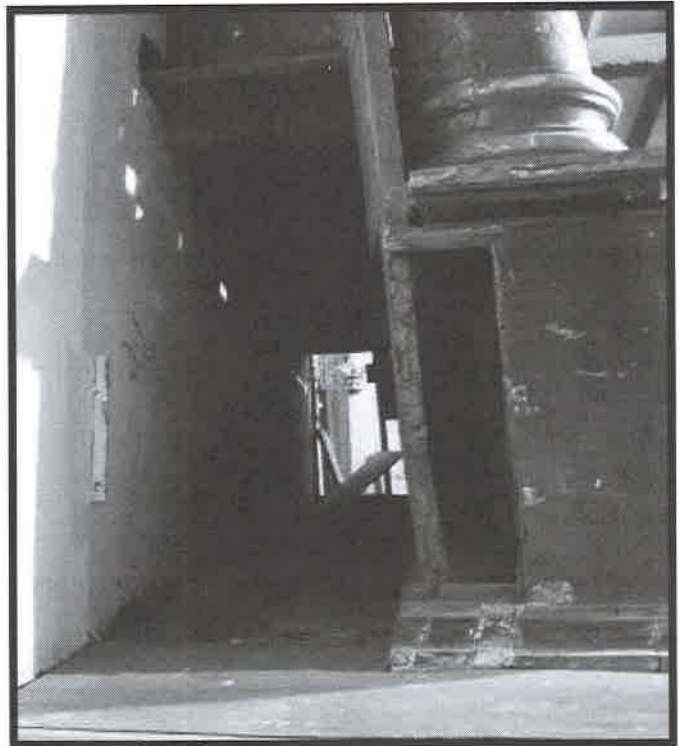
Parte trasera del retablo en malas condiciones
