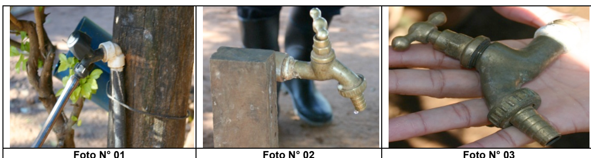
Foto N° 01: Canillas proveídas a los beneficiarios presentan desperfectos y producen pérdida de agua
