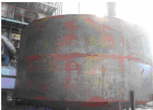
Base del filtro húmedo de la caldera 5.
