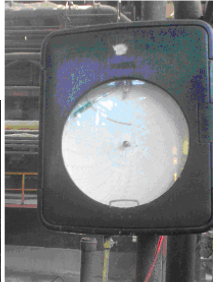
Caudalímetro fuera de funcionamiento.
