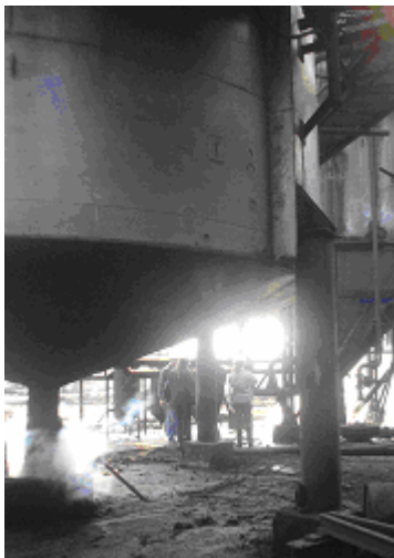
Filtros húmedos funcionando (se observa salida de agua).
