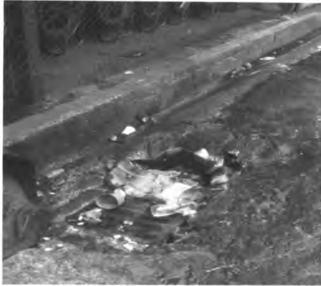
Sumidero obstruido con basura
