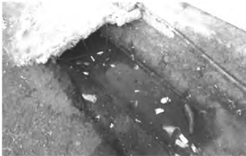
Sumidero sin flujo por taponamiento
