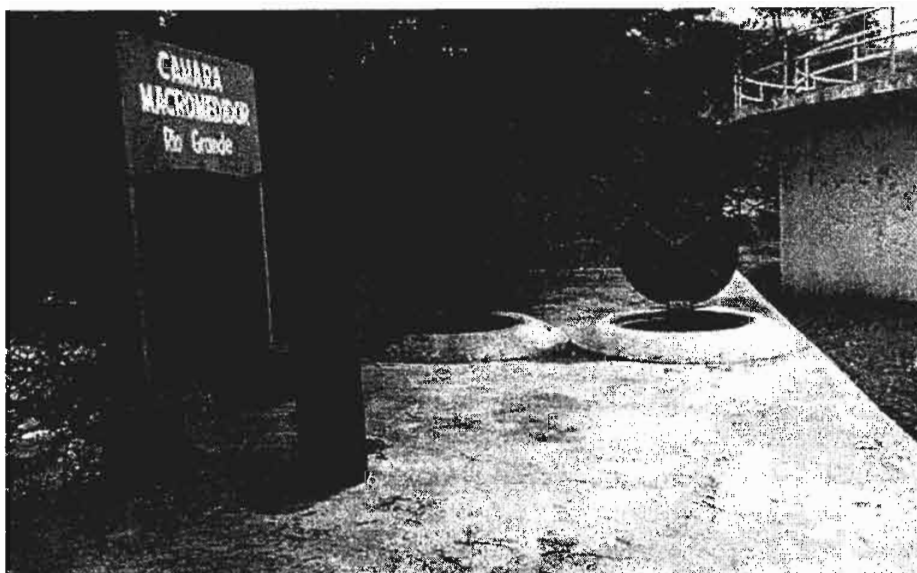
Foto N° 11 Cámara de medición de ingreso a la PTA captación Río Grande.
