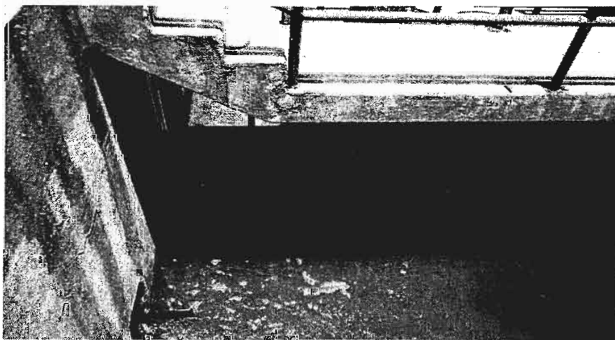
Foto N°6 Compuertas regulan el ingreso de agua a los Desarenadores
