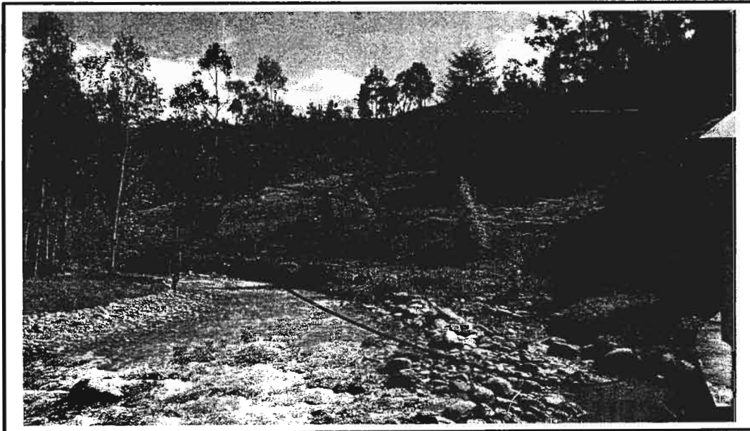
Foto n.º 2: Área ribereña, margen izquierda del río Grande, cuyas estructuras de protección y encauzamiento del río se encuentran deterioradas, próximo a las instalaciones de la captación.
