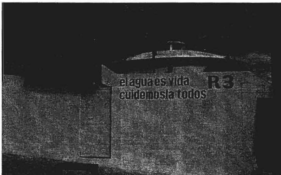
Foto N° 21 Reservorio R3 Sistema Santa Apolonia
