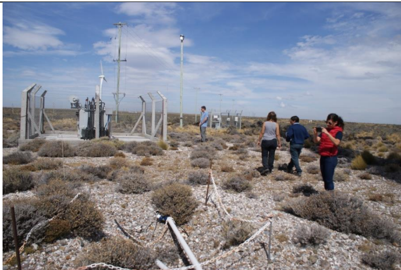
2) Vista del transformador de uno de los aerogeneradores.
