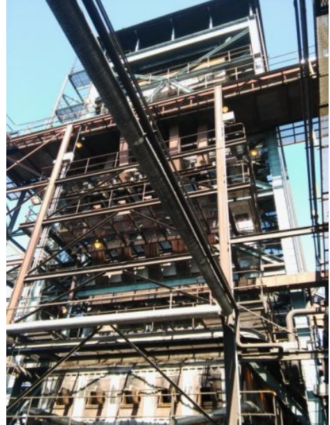
8) Vista de una de las calderas.
