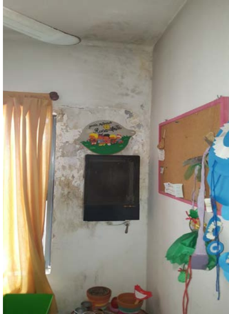
Foto: manchas de humedad y filtración en la sala.
