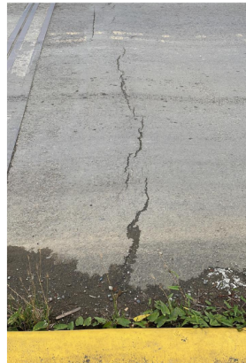
Agrietamiento en la superficie de ruedo Puente Envaco
