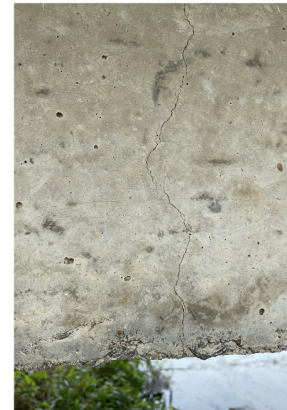
Grietas en vigas de concreto Puente vehicular de acceso a vivienda
