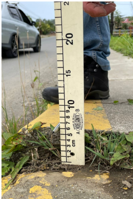
Asentamiento en el acceso de aproximación Puente Envaco
