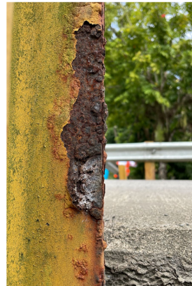
Oxidación, ampollas y descascaramiento en baranda Puente Escuela
