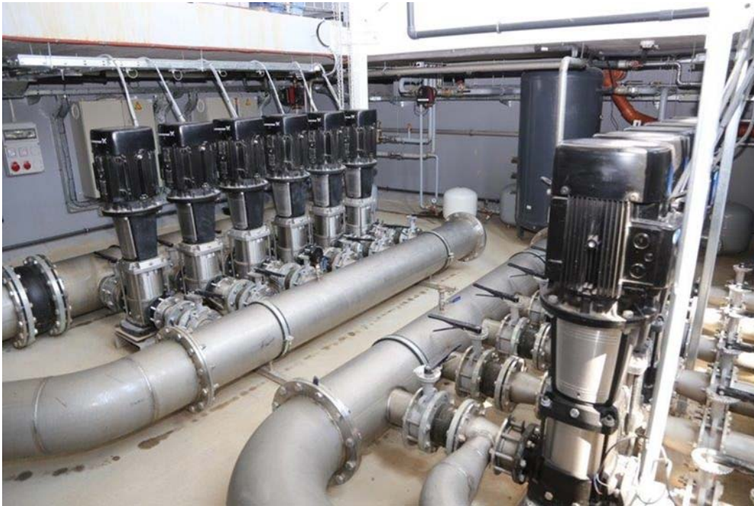
Foto 2 - Aufbereitungsmaschinerie in der Aufbereitungsanlage der Gemeinde Bogyszló im Gebiet Szekszárd (Ungarn)
